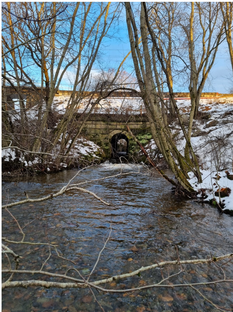
Figur 2. Bildet er tatt nedstrøms eksisterende kulvert under jernbanen. I dette området renner bekken i et nokså bredt løp, og substratet består av stein og grus. Bekkekantene består av en leirravine med godt utviklet kantvegetasjon. Kulvert som fører eksisterende landbruksvei under jernbanen, er så vidt synlig til venstre for bekkekulverten. Foto: Rambøll, 2022.
