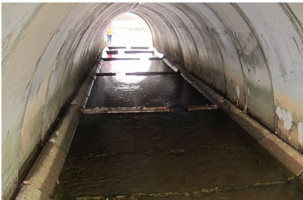
Figur 8. Eksempel på tilrettelegging av kulvert med terskler for å bremse vannhastigheten. Bildet er hentet fra Statens vegvesens rapport nr. 459 – Frie fiskeveger [12].
